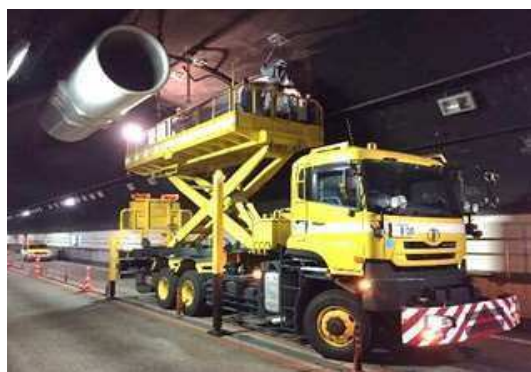
《ジェットファン点検作業》
